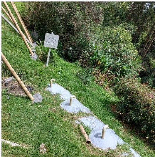
Figura 9. Pozo séptico de la planta de lácteos Buenavista
