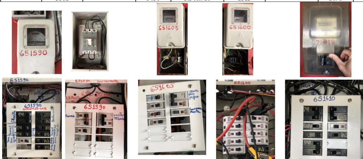
Figura 23. Distribución de contadores y tableros de protecciones.
