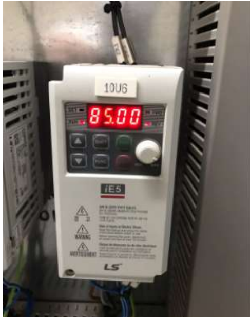
Figura 14. Parametrización variador de velocidad agitador.
