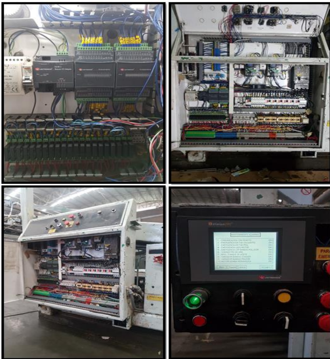
Figura 58. Montaje nuevo sistema de control eléctrico. Fuente: Elaboración propia.
