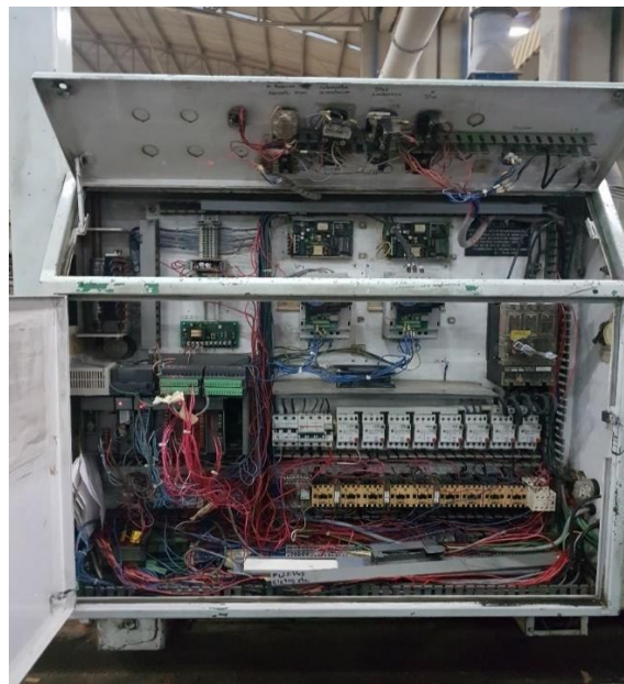
Figura 19. Tablero control eléctrico Stacker. Fuente: Elaboración propia.
