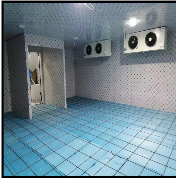
Figura 17, cuarto de refrigeración[36]
